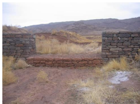
شکل ۴- نمای پایین دست یکی از بندهای توری سنگی که به دلیل کم بودن فاصله با بند بعدی حوضچه آرامش آن در رسوبات سد پایین دست دفن شده است.
