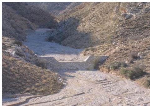
شکل ۵- نمای پایین دست یکی از بندهای سنگ و ملاتی که به دلیل کم بودن فاصله با بند بعدی حوضچه آرامش آن در رسوبات سد پایین دست دفن شده است.
